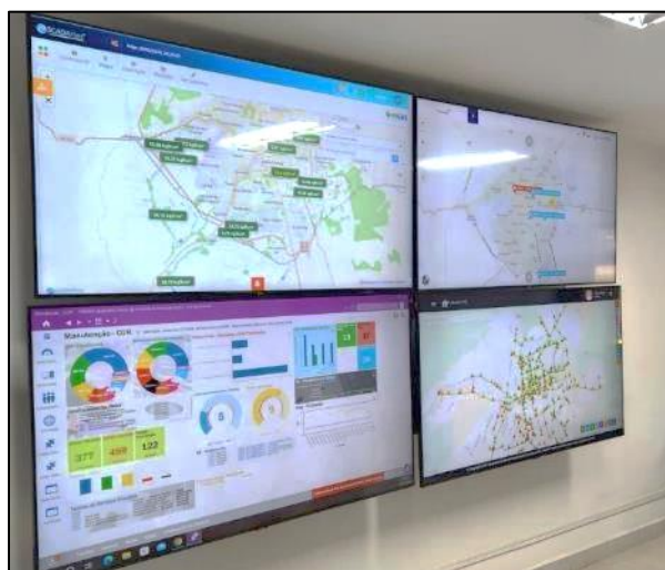
Painel de monitoramento do sistema de distribuição
